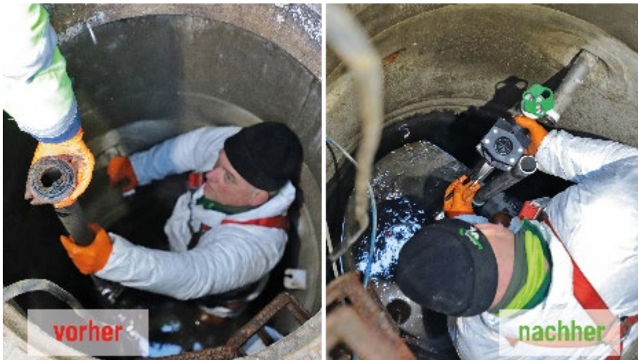
Bild 2: Ausbau der alten Schachteinbauten, welche aufgrund von Korrosion und Ablagerungen durch das neue Einbauset DN 40 ersetzt werden.
